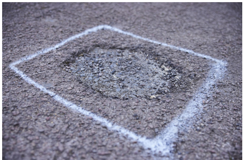
Nahaufnahme eines Schlaglochs in einer zur Reparatur markierten Straße; Copyright: Adpic - Image(s) licensed by Ingram Image
